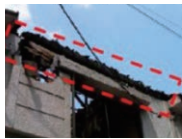
落下物の確認
